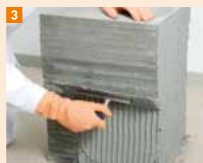
3 Pomocí zubové stěrky (6-8 mm) je lepidlo nanášeno na dvě čelní hrany vyskládaných dlaždic
